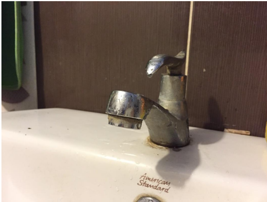
ภาพ : แสดงก๊อกน้ำรั่นประหยัดน้ำจากห้องน้ำครูอาคาร 1
