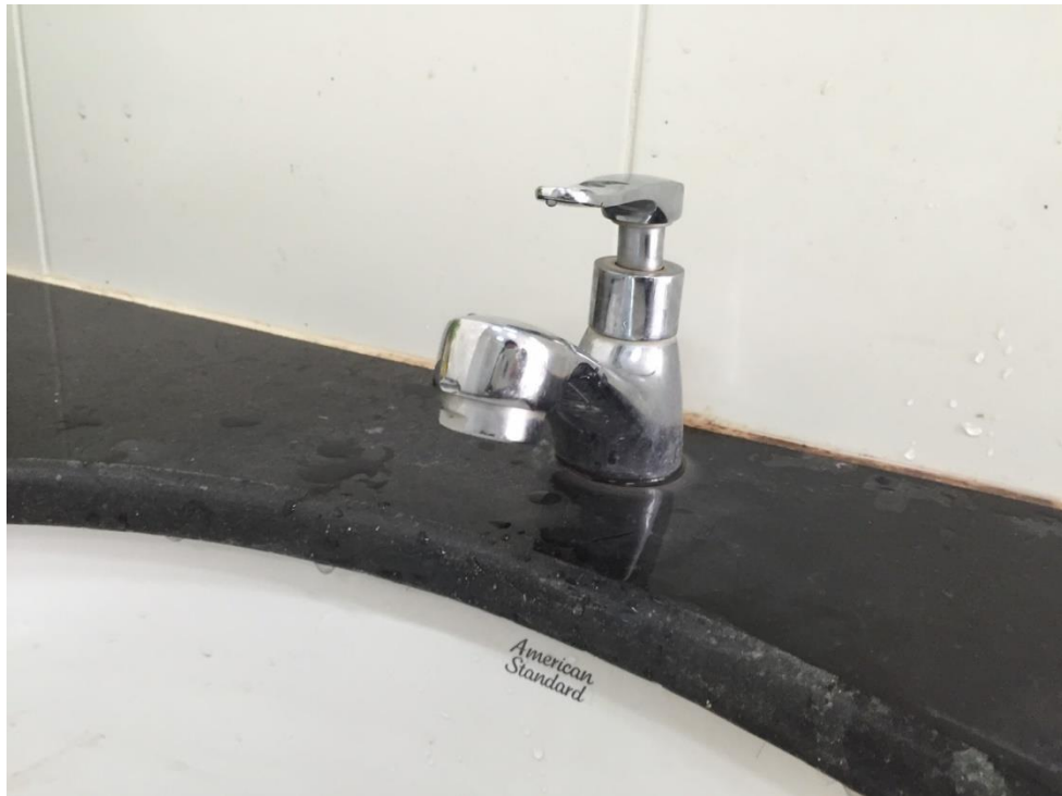
ภาพ : แสดงก๊อกน้ำรั่วประหยัดน้ำจากห้องน้ำอาคาร 7
