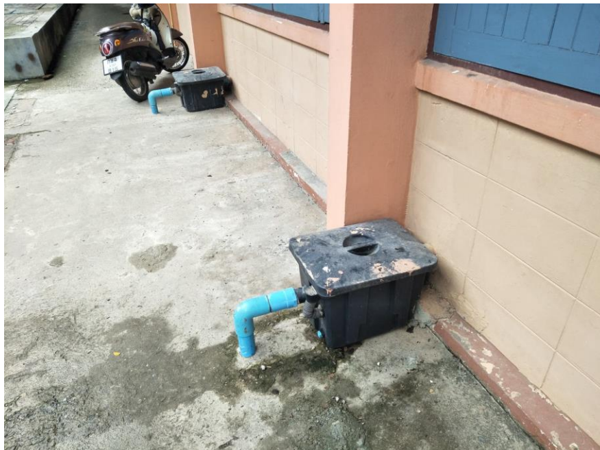
ภาพ : แสดงสถานที่ติดตั้งถังดักไขมัน
