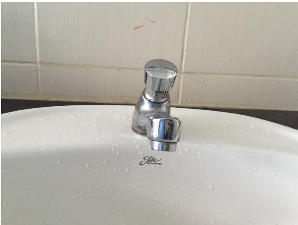
ภาพ : แสดงก๊อกน้ำรั่นประหยัดน้ำจากห้องน้ำอาคาร 6
